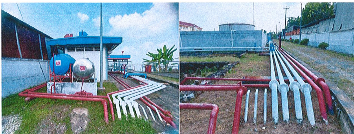
Hình 8. Hệ thống đường ống nhập/xuất hàng hóa của kho
